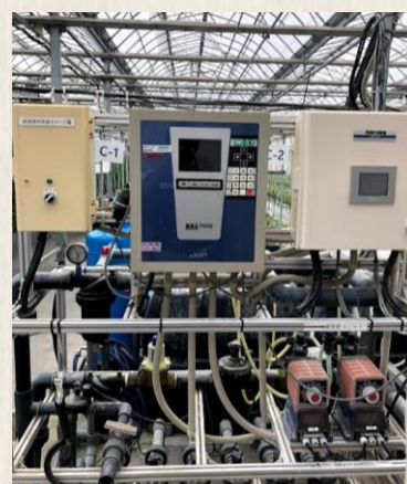
養液王 700 (日本オペレーター株式会社)
